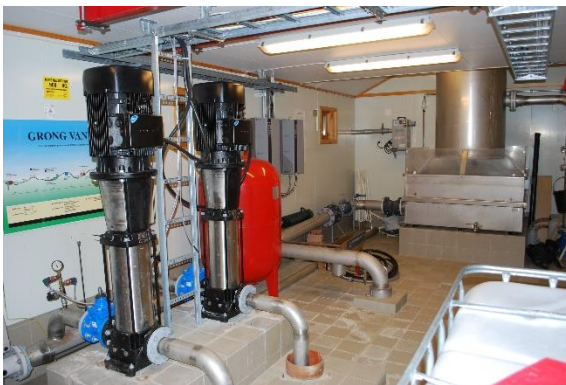
De nye pumpene ved Grong vannverk, Farstøa
