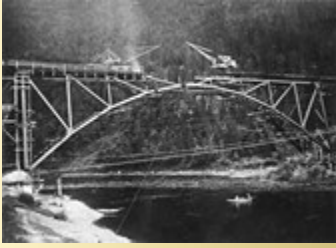
Bygging av Fossland bru i 1935. Bilde utlånt av Inger Faanes/Inger Kristin Lindsethmo
