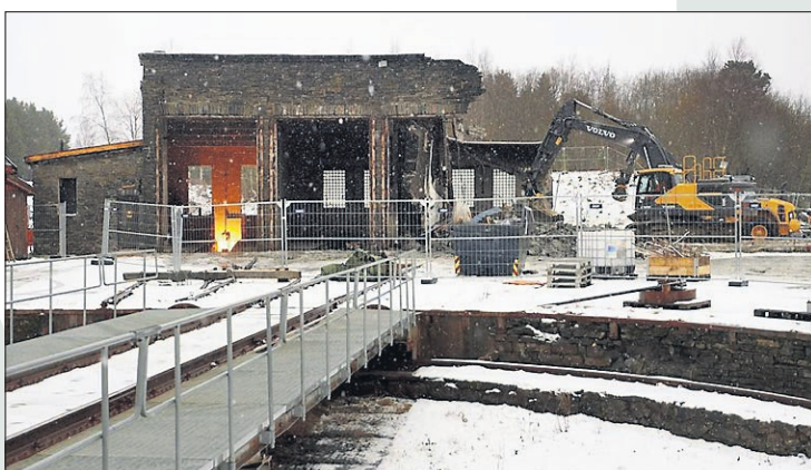
RIVES: Lokstallen på Øvre Nausthaugen har omfattende betongskader og har lav teknisk standard. Derfor har Jernbaneverket bestemt å rive lokstallen og velferdsbygget.
