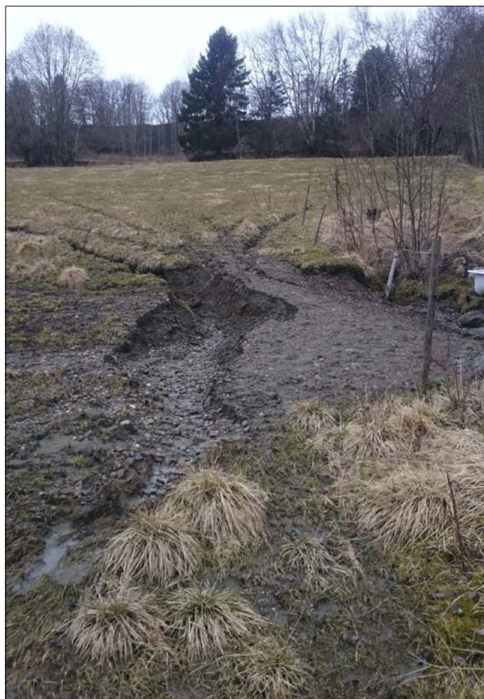
SMIL: Erosjon i grøft.
