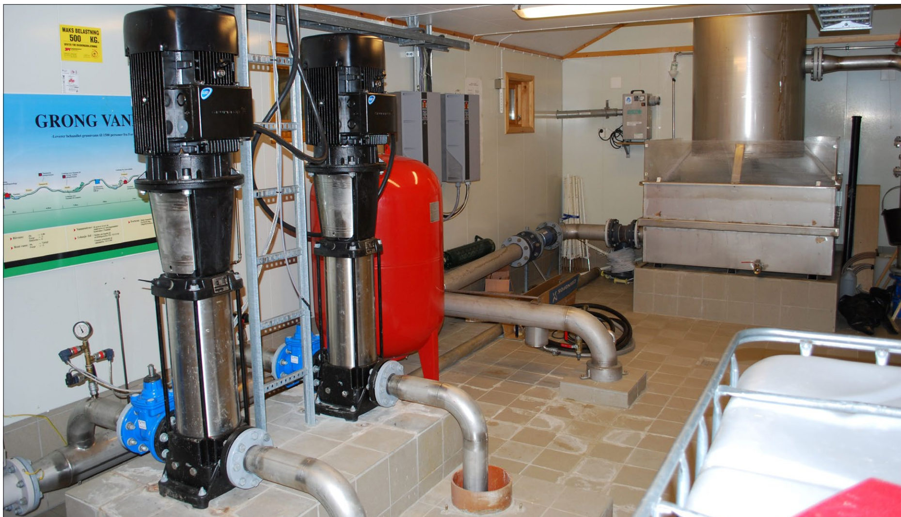
PUMPER: De nye store pumpene ved Grong vannverk - Farstøa.
